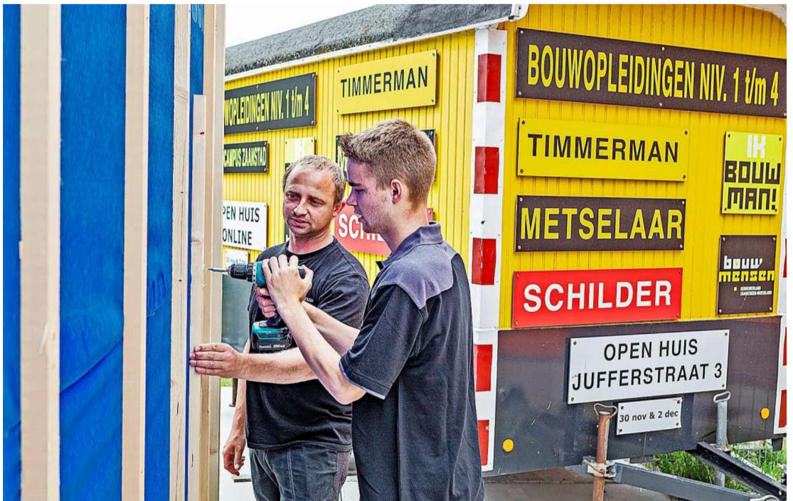
Ties Zonneveld bouwt met de hulp van een timmerman van Van Lith aan het tiny house.
